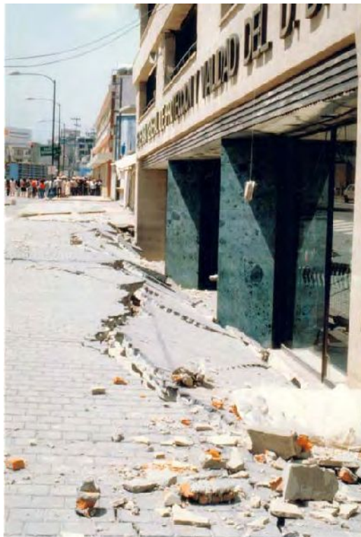
Figura 1.14 Asentamiento súbito de edificio en la ciudad de México, durante el sismo del 19 de septiembre de 1985
