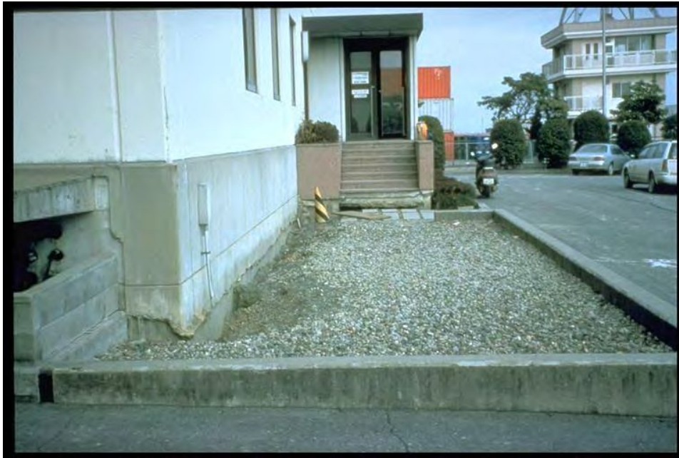
Figura 1.13 Asentamiento de edificios, en Kobe, Japón durante el sismo del 17 de enero de 1995, M = 6.69 (Fotografía de la Kobe Collection NISEE, University of California, Berkeley)
