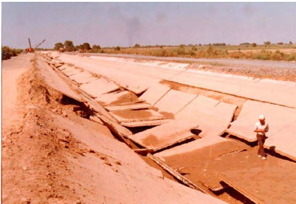
Figura 1.20 Daños debidos a la licuación, en el canal Nuevo Delta, en el distrito de riego No. 14, Mexicali, Baja California, durante el sismo del 15 de octubre de 1979 ( M = 6.4 )
