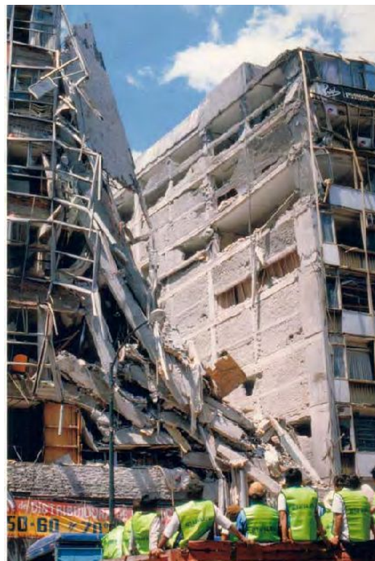
Figura 1.8 Colapso de edificios en la ciudad de México, sismo en México, 19 de septiembre de 1985
