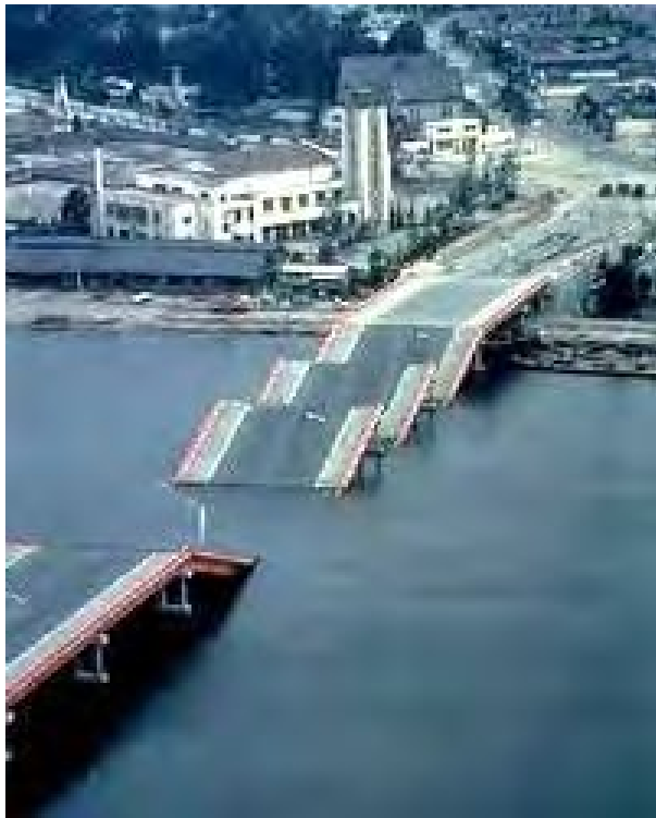
Figura 1.3 Colapso del puente Showa debido a licuación, en Niigata, Japón, durante el sismo del 16 de junio de 1964, M = 7.4 (Fotografía de la Godden Collection NISEE, University of California, Berkeley)
