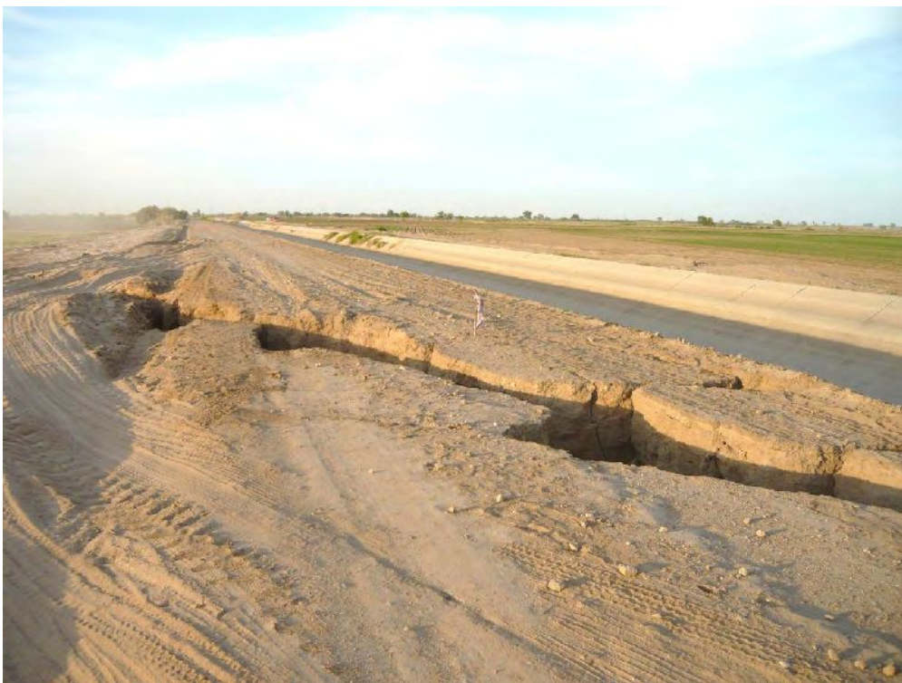
Figura 1.21 Daños a la infraestructura de riego, en el distrito de riego No. 14, Mexicali, Baja California, durante el sismo del 4 de abril de 2010 ( M = 7.2 )
