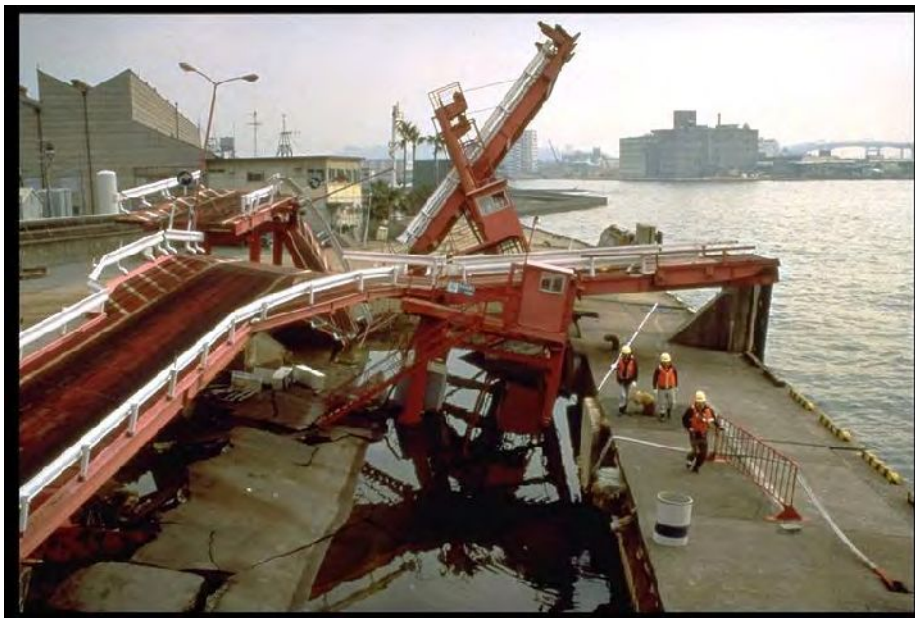
Figura 1.4 Colapso de la rampa de acceso al transbordador Higashi-Kobe, durante el sismo del 17 de enero de 1995 (Fotografía de la Kobe Collection NISEE, University of California, Berkeley)
