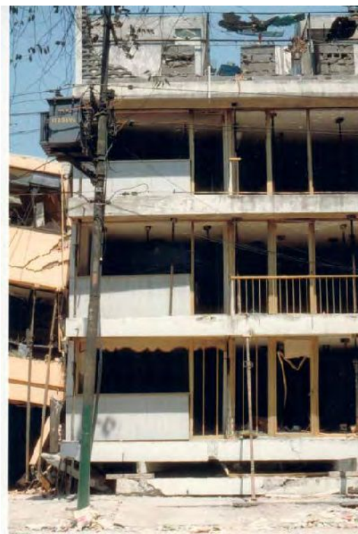
Figura 1.15 Asentamiento súbito de edificio en la ciudad de México, durante el sismo del 19 de septiembre de 1985
