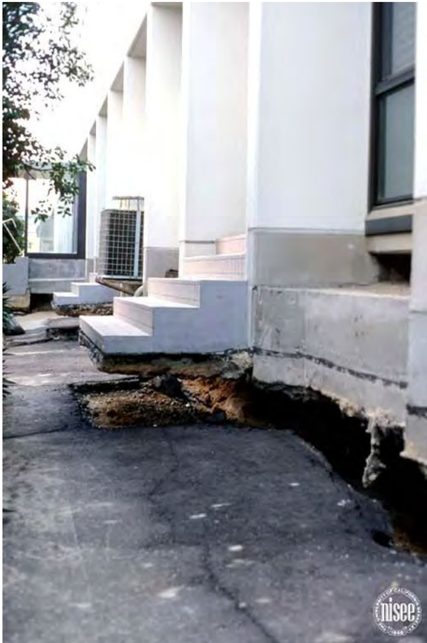
Figura 1.12 Asentamiento de edificios, en Kobe, Japón, durante el sismo del 17 de enero de 1995, M = 6.69 (Fotografía de la Kobe Collection NISEE, University of California, Berkeley)
