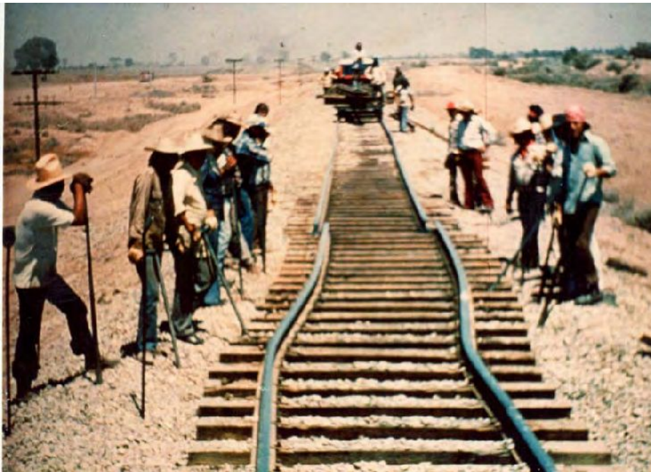
Figura 1.19 Vía de tren doblada debido a licuación, en el distrito de riego No. 14, Mexicali, Baja California, durante el sismo del 15 de octubre de 1979 ( M = 6.4 )
