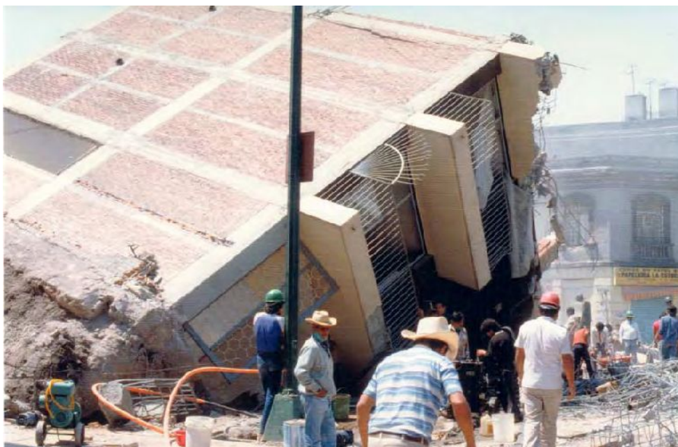
Figura 1.10 Colapso de edificio en la ciudad de México, debido a falla de cimentación por capacidad de carga, sismo del 19 de septiembre de 1985
