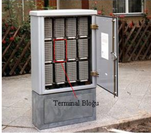
Resim 4.1: Saha dolabı terminal bloğu
