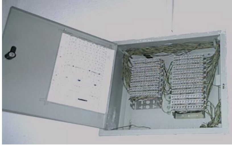
Resim 4.17: Bina ana giriş terminal kutusu iç yapısı
